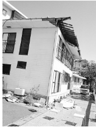
被害の大きかったデジジー寮
