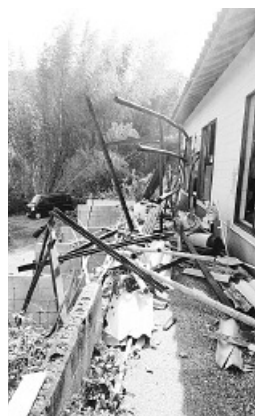
牛舎の壁に鉄骨がめりこむ
